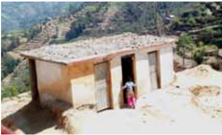
Die stark in Mitleidenschaft gezogenen Toiletten.
