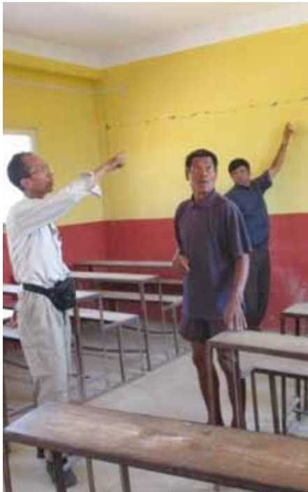
Ramesh Chitrakar begutachtet Risse im Schulneubau.
