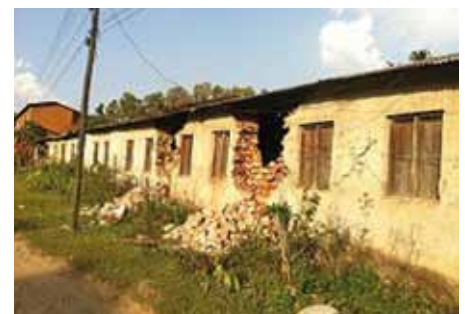
...während an den Altbauten große Schäden aufgetreten sind.
