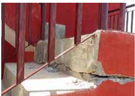
Die Treppen sind in Mitleidenschaft gezogen.
