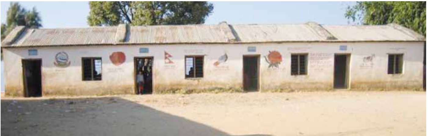
Die heruntergekommene Schule in Duipipal soll durch einen Neubau ersetzt werden.
