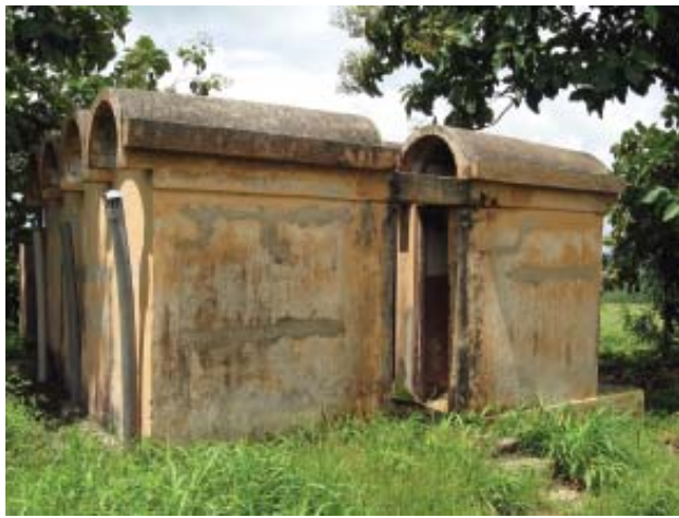
Blick auf die Toilettenanlage der Schule in Animadé. Die Innenausstattung ist weitgehend zerstört und unbenutzbar.
