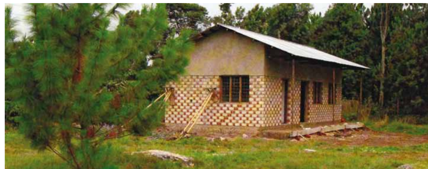
Die neue Schreinereiwerkstatt in Ntoma stellt sich im Rohbau schon als schmuckes Gebäude dar.
