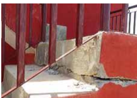
Die Treppen sind in Mitleidenschaft gezogen.
