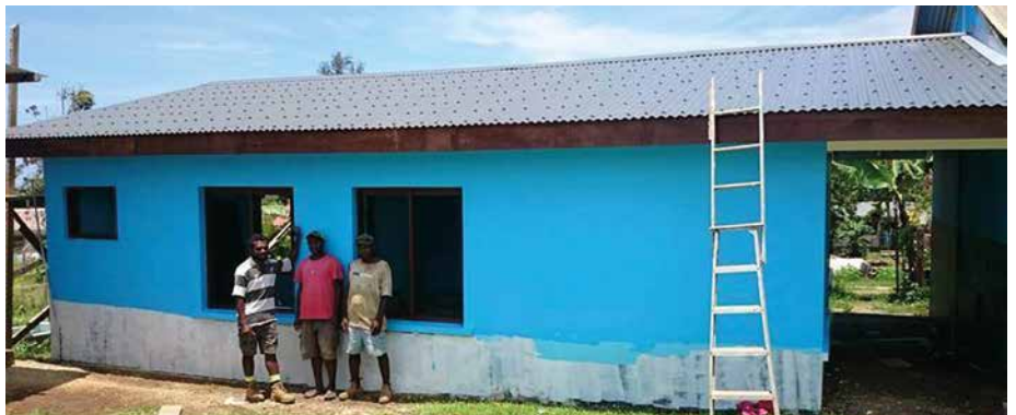
Vorher – nachher: Ein Klassenraum der East Vila School vor und nach dem Wiederaufbau.
