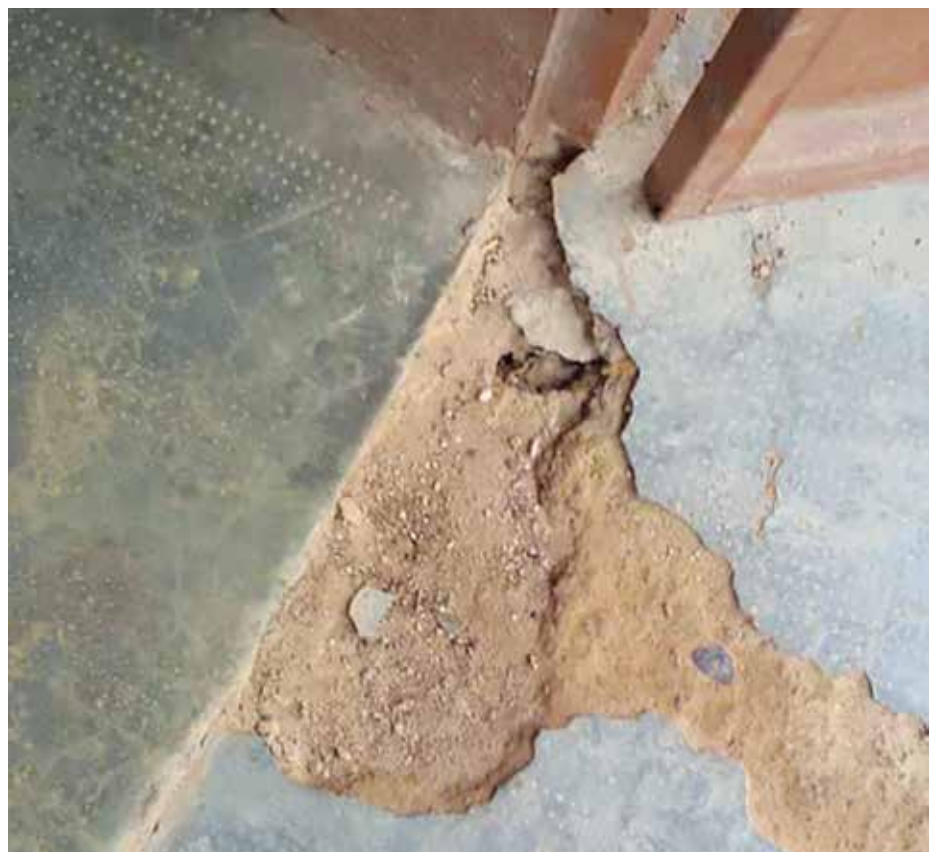
Löcher und Spalten in den Türschwellen sind gefährlich.
