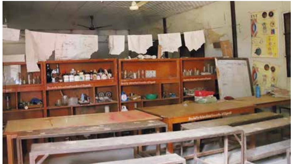
Seit dem Erdbeben werden einige Klassenräume notgedrungen als Lager genutzt.
